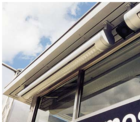
Entré- och skyltbelysning i Bagarmossen BPS-tub / Hamm
